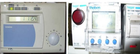
Abb. 3.9 Wärme- und Lüftungsregler, Internatsgebäude
