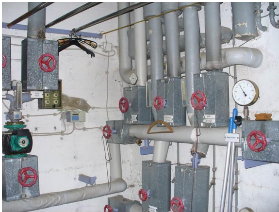
Abb. 3.6 Zentrale Wärmeversorgung, Internatsgebäude
